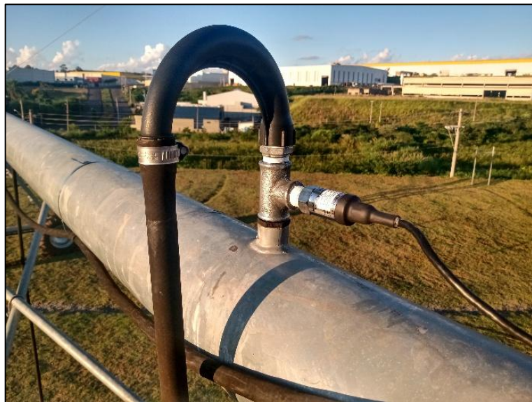
Figura 20 - Instalação mecânica do sensor de pressão.
