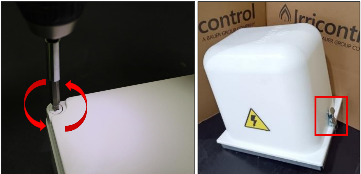
Figura 23 - Abertura da caixa plástica e remoção da cobertura da caixa de controle.
