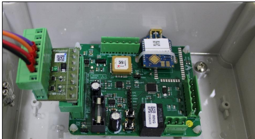
Figura 56 - Instalação do novo Shield na placa Imanage.
